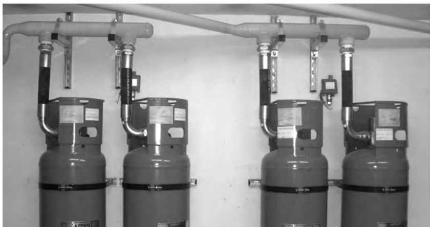
Система газового пожаротушения
